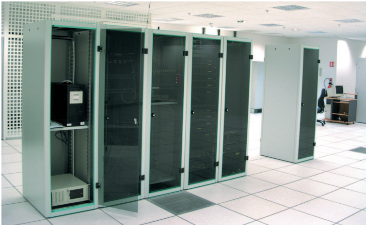
Des tours StoriQ T d'Intelligence installées chez Télécity (Plaine Saint-Denis) hébergent le système de partage des médias de Dubbing Brother.
